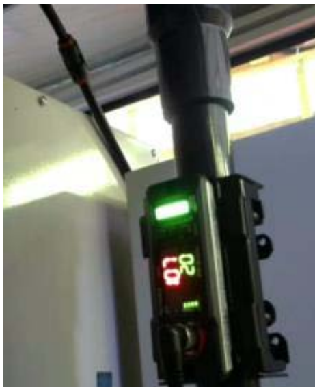
写真5 流量計モニター
